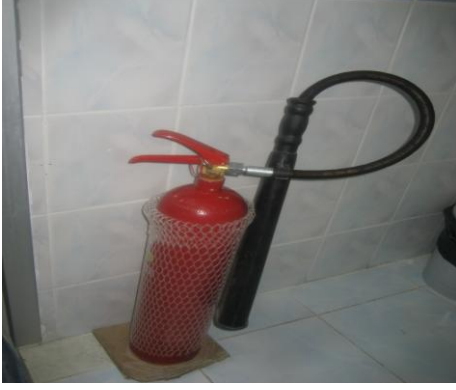
Şekil 4. Yangın tüpleri sabitlenmemiştir.
